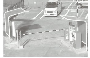
ゲート式駐車場管理システム
