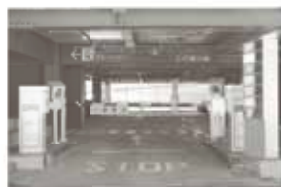
ゲート式駐車場管理システム
