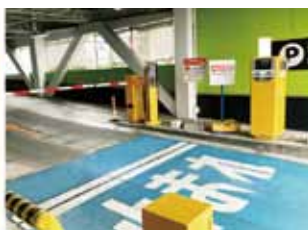
若宮駐車場設置状況
