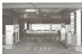
ゲート式駐車場管理システム
